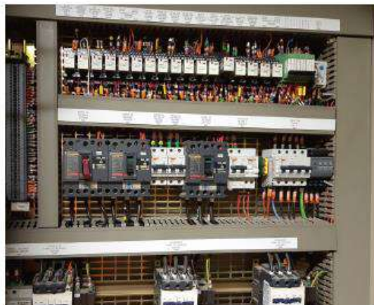
Déconsignation électrique des groupes de pompage in situ
