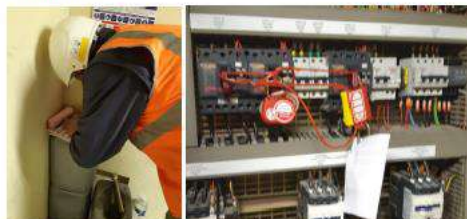
Consignation des équipes de pompage du poste de relevage
