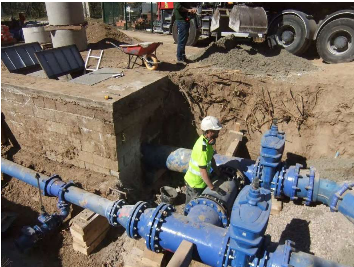
BASSIN EAUX BRUTE FUYEAU
