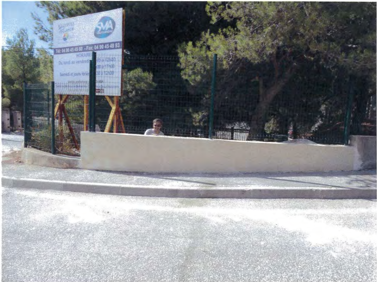
Reconstitution du mur d'entrée suite à un accident avec un véhicule privé venu percuter l'entrée.
