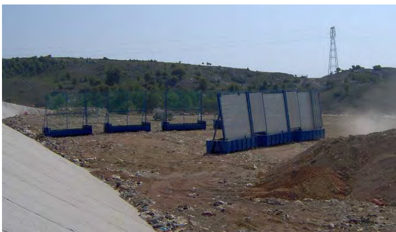
Bennes pare-vent et anti-envol sur casier en exploitation
