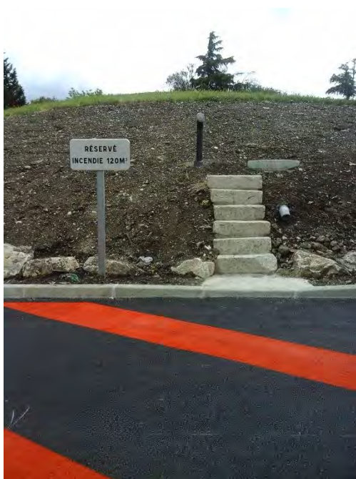
Réserve incendie de la déchèterie de Pélissanne
