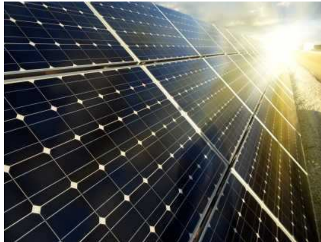
Photo de l'installation
