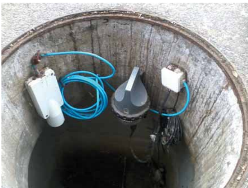
Système de contrôle du DO – La Bouilladisse
