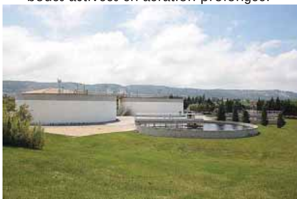
Station d'épuration de Châteauneuf-les-Martigues
