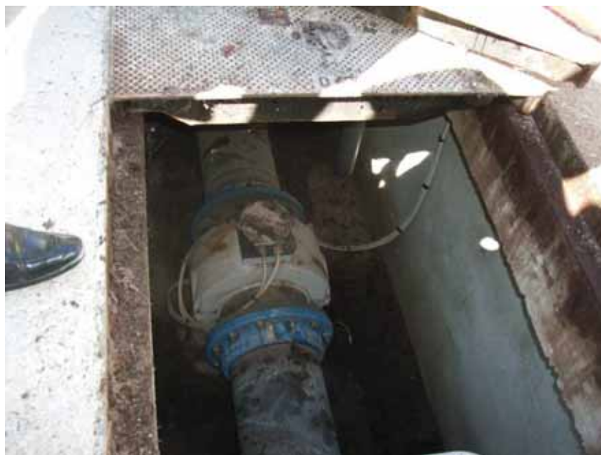
Débitmètre mesure effluents de Carnoux
