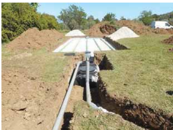
Installation d'assainissement non collectif
