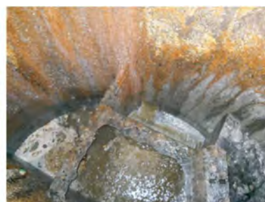
Les traces d'infiltrations
