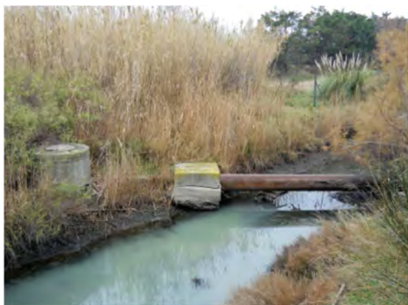
Les ancrages sont instables.
