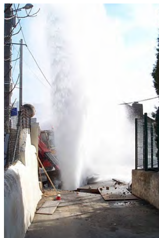
Geyser suite à une rupture de canalisation
