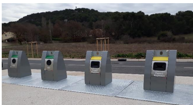
Dispositif enterré Commune de Cabriès
