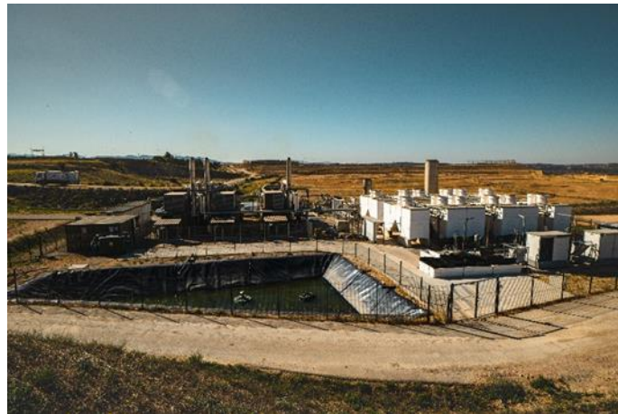
Plateforme de valorisation du biogaz
