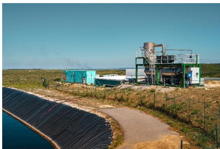
Station de traitement des lixiviats
