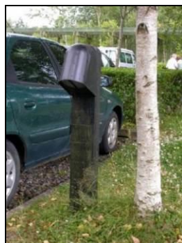
Exemple d'éclairage au sol
