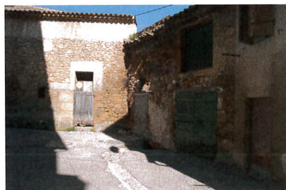
Bâtiment en ruine
