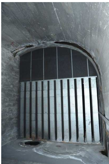
Figure 3 : Vue de l'étage de silencieux côté ventilateur
