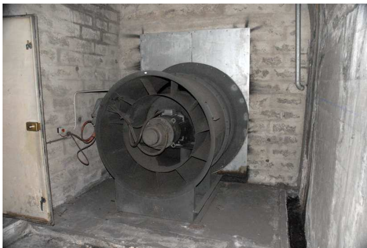
Figure 4 : Vue du ventilateur Ozanam du côté puits
