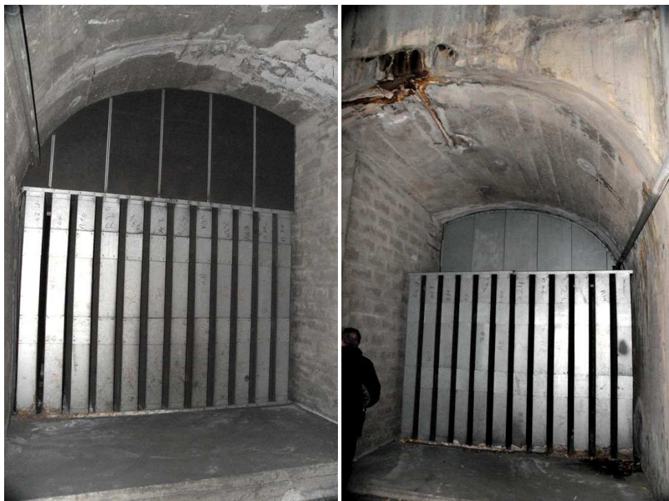
Figure 5 : Vue des baffles acoustiques du côté ventilateur et du côté puits
