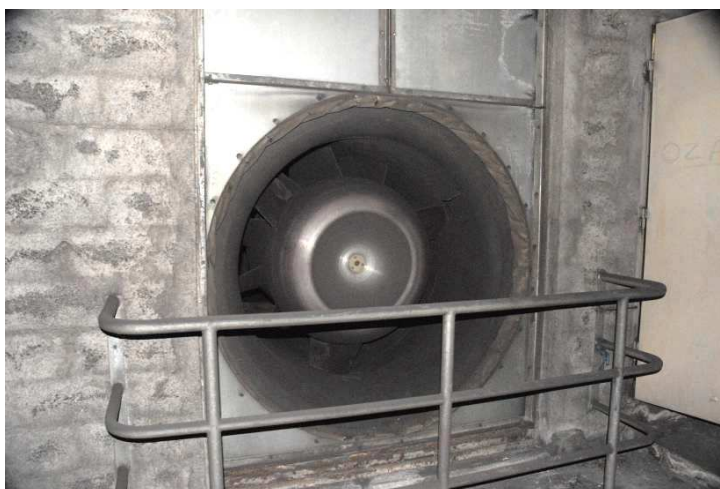
Figure 3 : Vue du ventilateur Ozanam du côté tunnel
