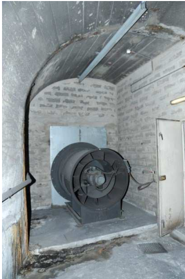
Figure 2 : Vue du ventilateur côté silencieux
